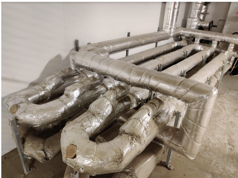
Figur 26. Inex powerpipe seriekopplade för värmeväxling till flerbostadshus. (Kauppinen, R., personlig kommunikation)
