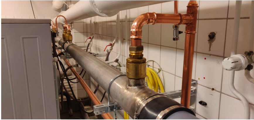
Figur 7. Liggande rörvärmväxlare iNEX GK kopplad till tvättstuga. (Inexie.se. U.Å)
