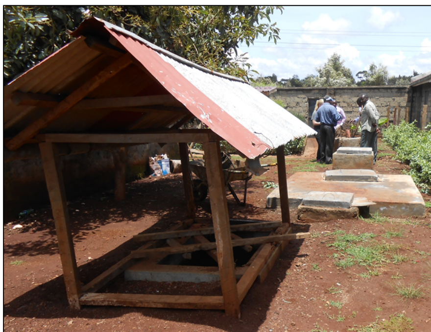
Figur 7. Installerad Kenbim anläggning, Nairobi, Kenya.
