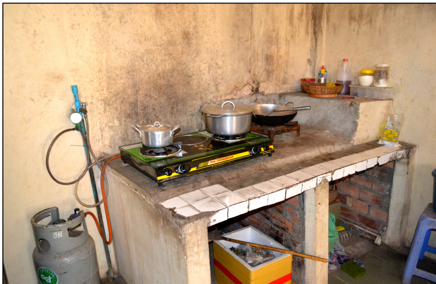
Figur 5. Installerad biogasspis, Kampoung Speu, Kambodja.
