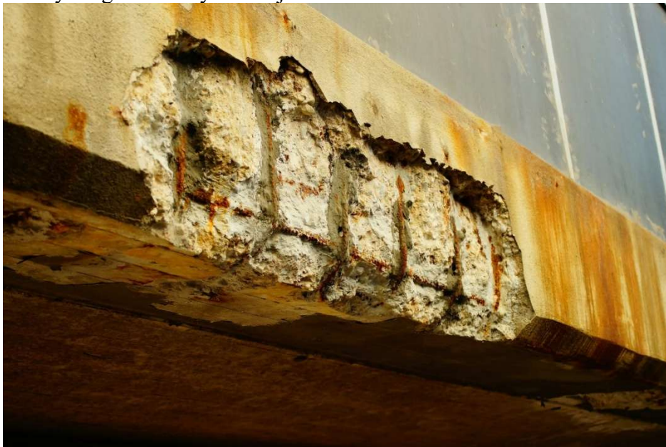
Figur 3.6 Spjälkning på grund av korroderande armering (Lenstadhus, u.å.)
