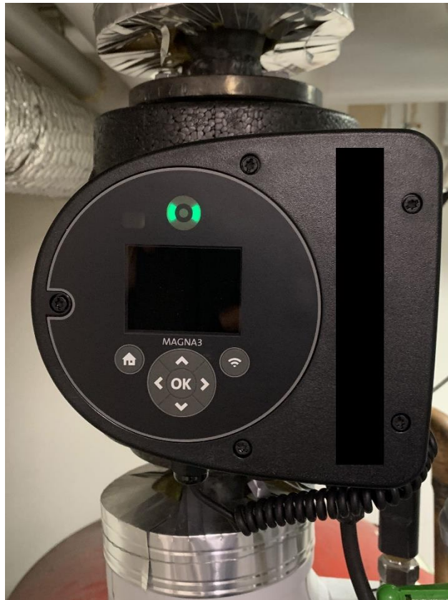
Figur 9: Cirkulationspumpen MAGNA3:s framsida med dess terminal bestående av en skärm och navigationsknappar, installerad på Vasagatan 12.
