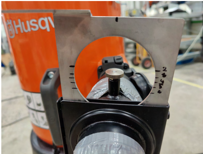
Figur 3.7: Markeringar på spjället, 1 är helt öppet, 6 är nästan fullständigt strypt
