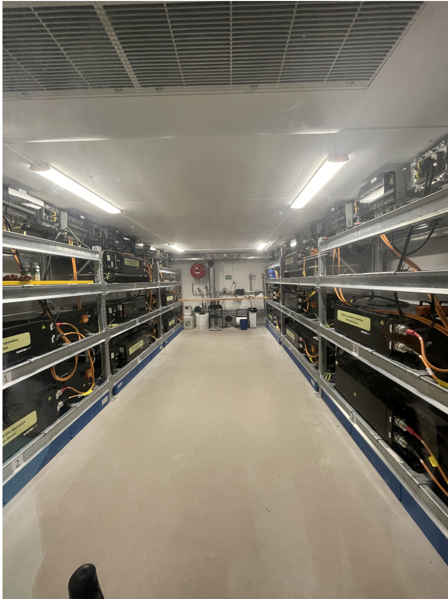
Figur 1: Brf Vivas rum avsett för batterilagring.
