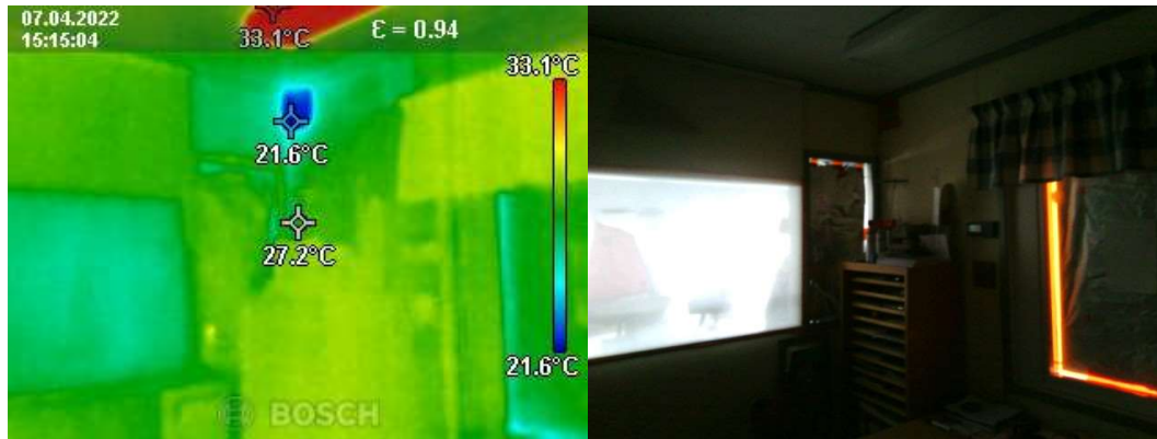
Figur 6.3 Bild av testrummets fönster under blower door. OBS. köldbrygga vid friskluftsventil samt fönster.
