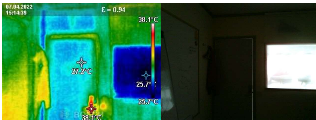
Figur 6.2 Bild av testrummets vägg mot salen innan blower door. OBS. köldbrygga vid innerdörr samt kiosklucka.
