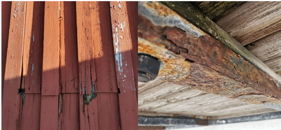
Figur 2.2 Till vänster; Rötskada och flagnad färg på Tribunens sydvästra fasad. Till höger; rostskada på skärmtakets metallram.
