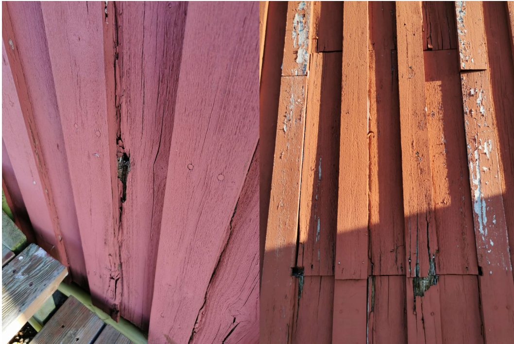
Figur 1.1 Bilder på rötskadade områden på sydvästra fasaden.
