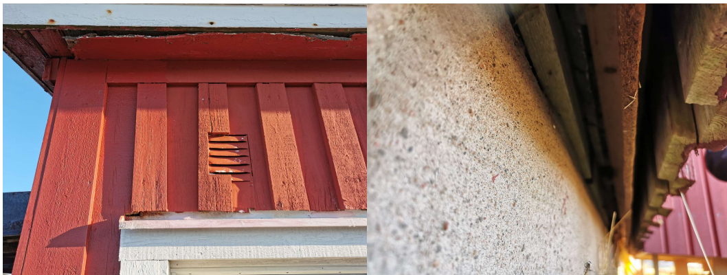
Figur 1.2 Till vänster; hängande takfotsinklädning och fuktskadad fasad över fönster åt SV. Till höger; överhängande materiallager i byggnadens yttervägg åt SV.
