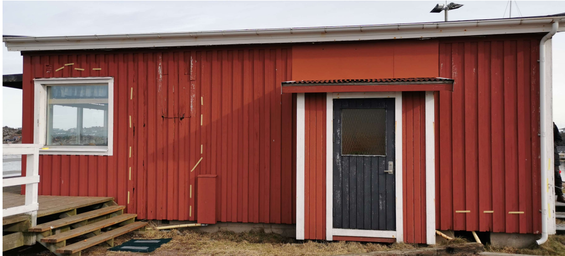
Figur 2.3 Fasad åt sydväst, tejp som markerar rötskadade områden.
