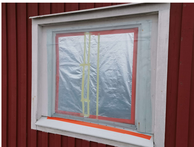
Figur 4.2 Fönster täckt med aluminiumfolie.
