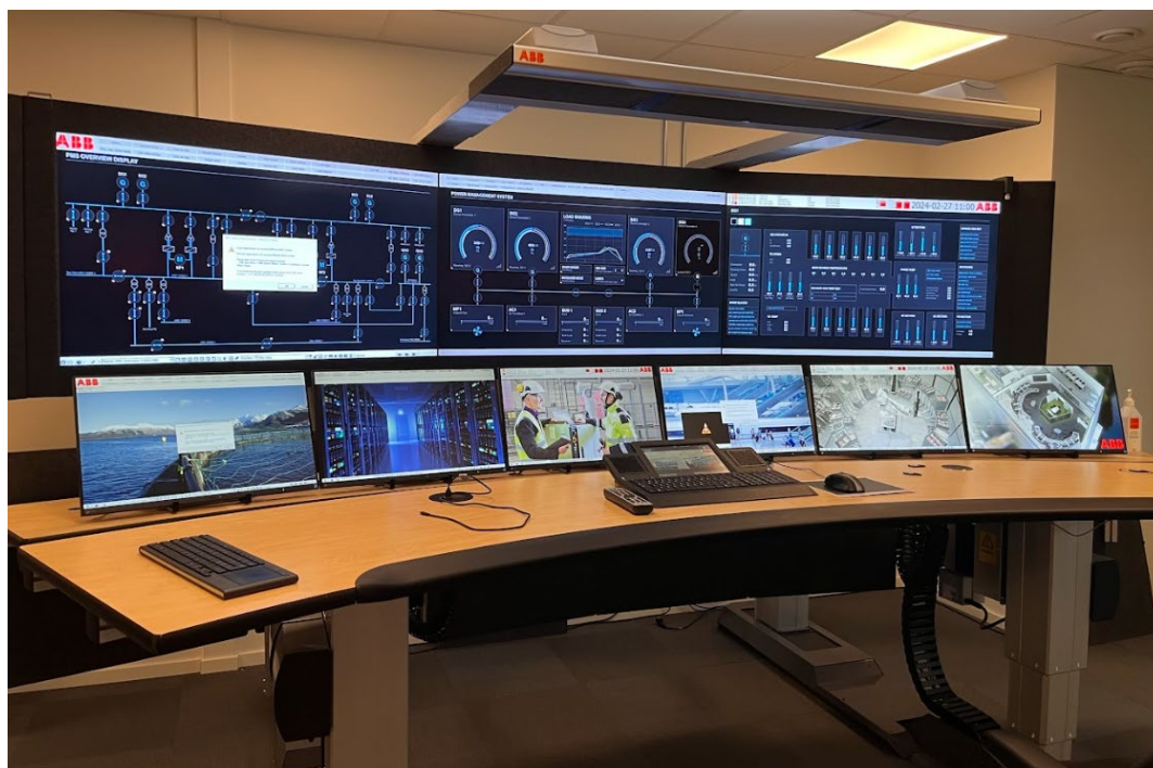
Figur 42. Kontrollrum "Extended Operator Workplace" från ABB
