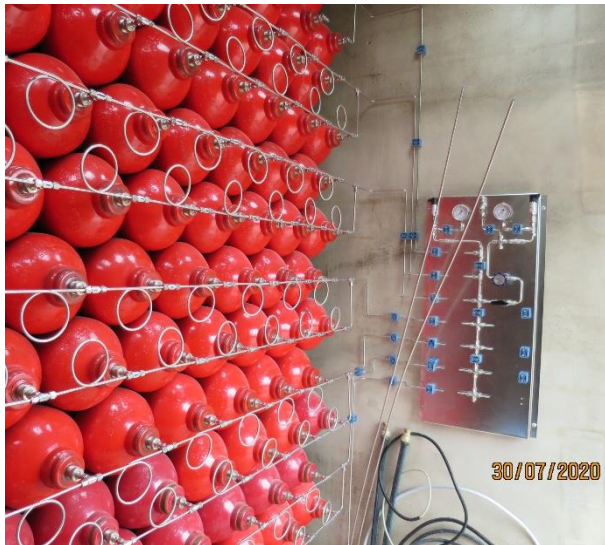
Figur 2.7: Inuti vätgaslagret där vätgasen lagras i ihopkopplade tankar.
