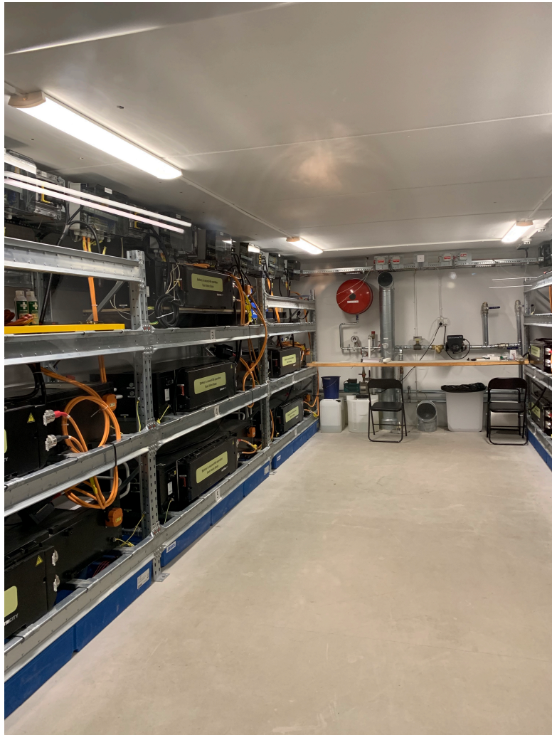
Figur 3. Bild som visar bussbatterierna från linje 55 som lagrar solenergi i brf Viva. Batterierna är avlångs och svarta. De ligger placerade på hyllor längs med väggarna. (2020-01-30).
