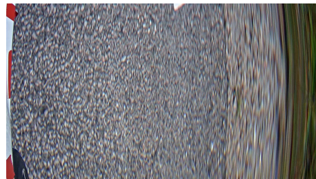
(d) Missing lane
