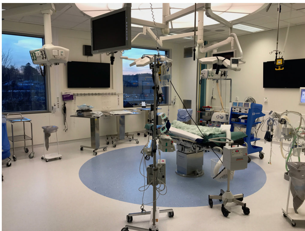
Figur 3.1: Operationssal vid Kungälvssjukhus som togs i bruk 2012.
