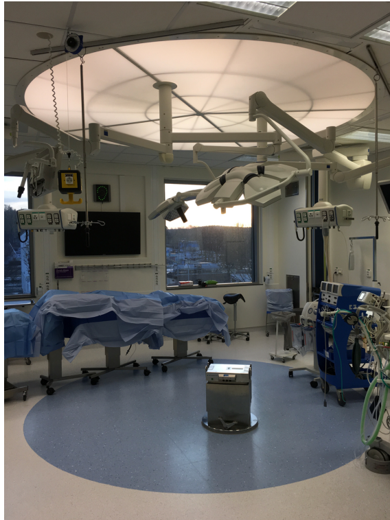
Figur 3.2: Tilluftsflödet i operationssalen förs in genom det cirkulära LAF-taket. På golvet under tilluftsdonet finns den sterila zonen markerad med blått.
