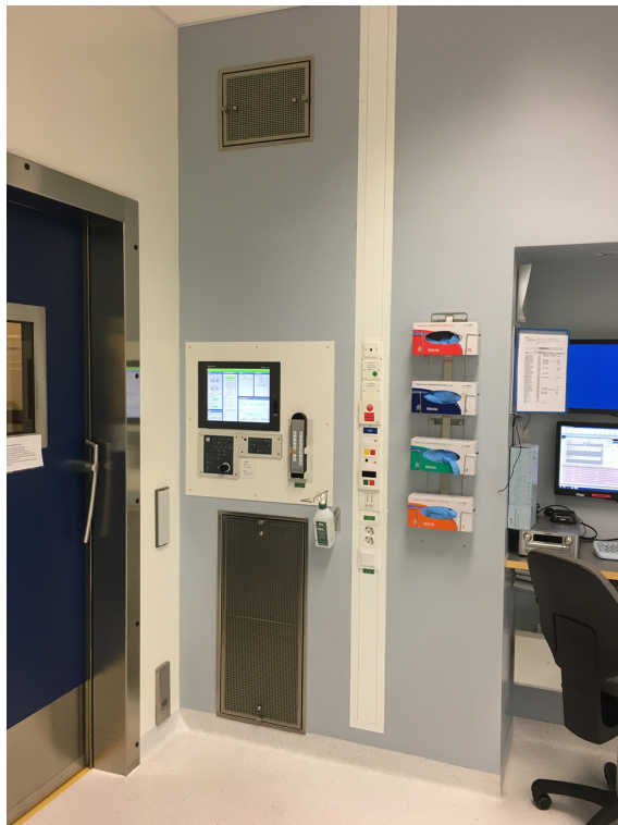
Figur 3.3: Totalt åtta gallerförsedda frånluftsdon finns i operationssalens fyra hörn, figuren visar två av dessa ventiler.
