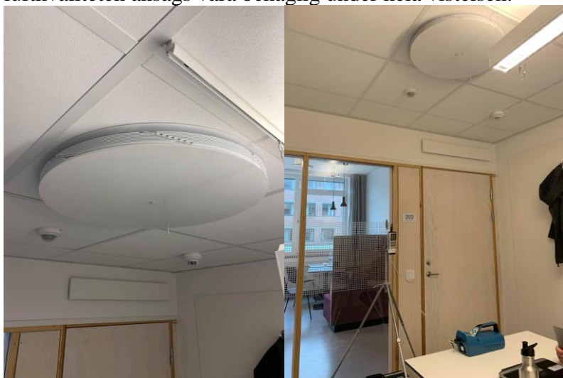
Figur 14 Tilluftsdonet samt mätuppställningen i grupprum 202.
