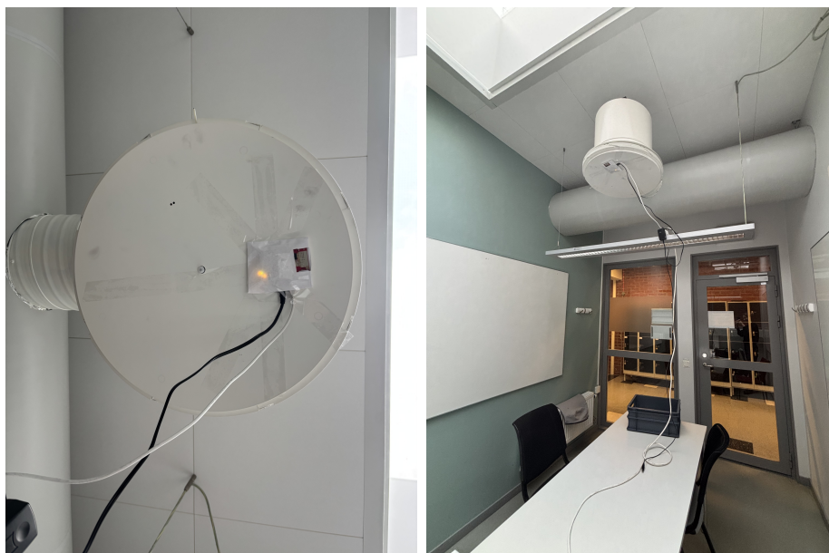
(a) Närbild av radarmodulen. (b) Hela radaruppställningen.
