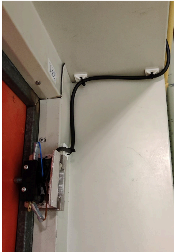
Figur 4.2.1: Dörrbrytare och kabeln till Flexicart.
