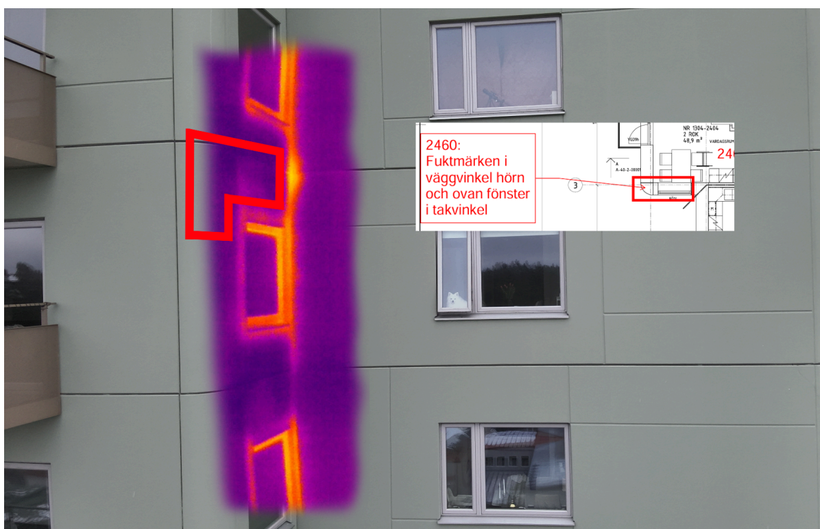
Bild 8: Bilden illustrerar ett exempel där en termisk avvikelse sammanfaller med ett rapporterat inläckage. Den röda markeringen visar var vattenläckaget har identifierats på insidan av klimatskalet, med tillhörande urklipp från ritningsunderlaget i bilaga 1.
