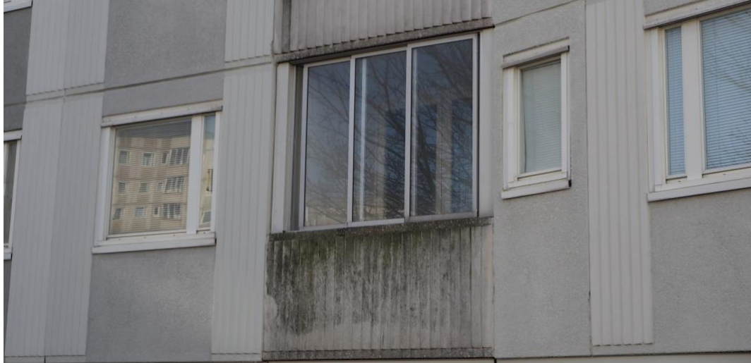
Bild 7: Cirkelkvarterets gamla balkongfronter i behov av renovering. Källa: Författarnas egen bild.
