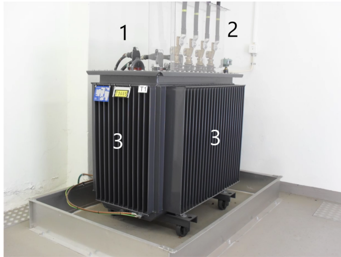
Figur 2.3: Oljeisolerad transformator i en nätstation i GENABs nät
