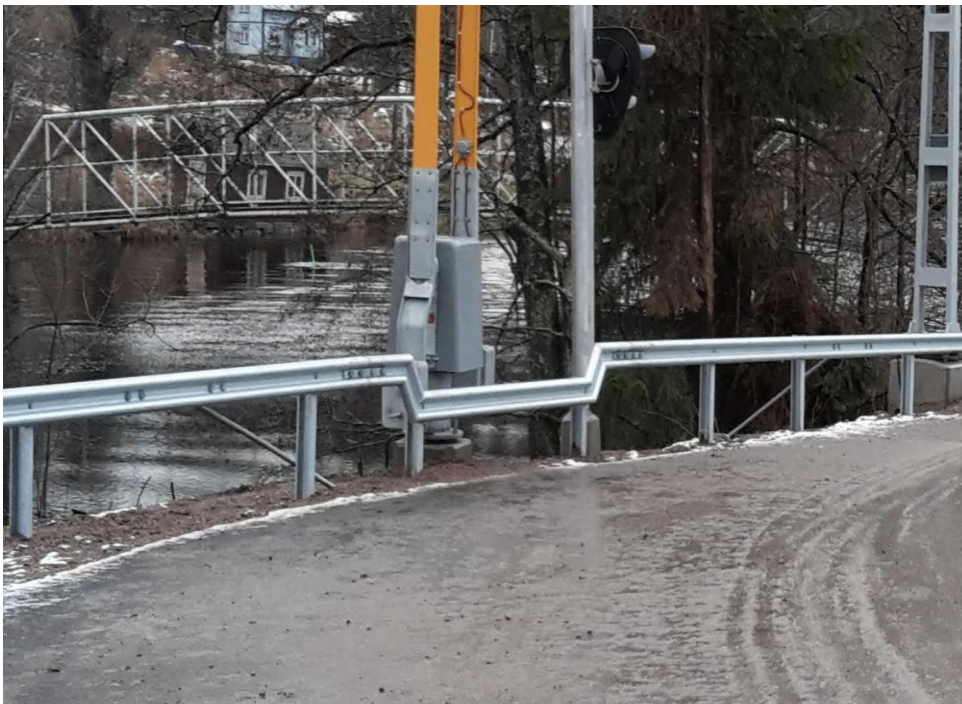
Figur 18. Modifierad konstruktion för vägräcke för att undvika farligt räckesavslut.
