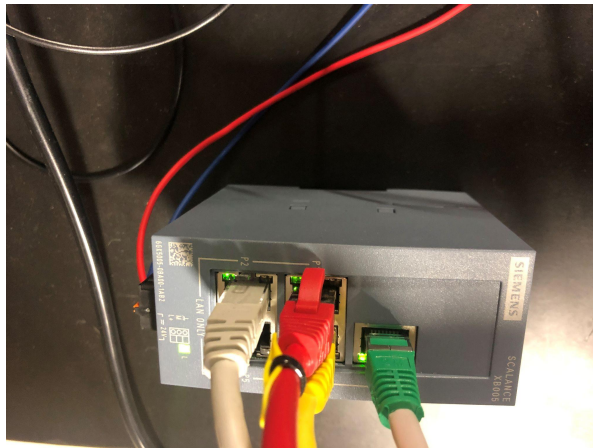
Figur 5.15. Nätverksswitch med inkopplade Ethernetkablar
