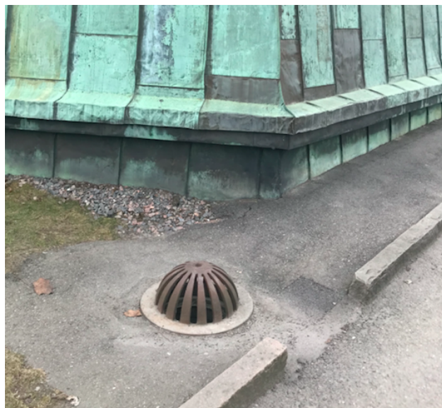
Figur 4: Dagvattenbrunn vid Kopparbunken. Foto: Evelina Skantz
