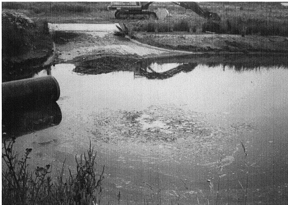
Bild 13. Mynningen av tilloppsledningen, sedimenthögar på ömse sidor om mynningen. I bakgrunden nedfartsrampen mot betongbotten.
