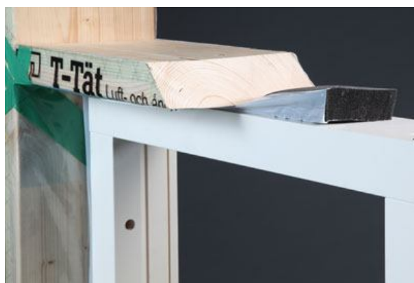
Figur 2.6. T-drevet är färdigmonterat och det har svällt och tätat spalten mellan fönsterkarmen och väggöppningen. Plastfolien är klämd mellan T-drevet på fönstret och ytterväggssmygen, (T-emballage, produktfakta).
