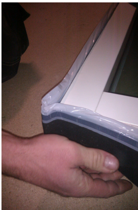
Figur 2.5. Montering av T-drev runt fönsterkarmen innan montering i yttervägg. Här har en hoptryckt "öglan" skapats med längden 0,5 multiplicerat med det verkliga spaltmåttet mellan fönsterkarmen och väggöppningen, (Studiebesök Gråbohöjd, 2011).
