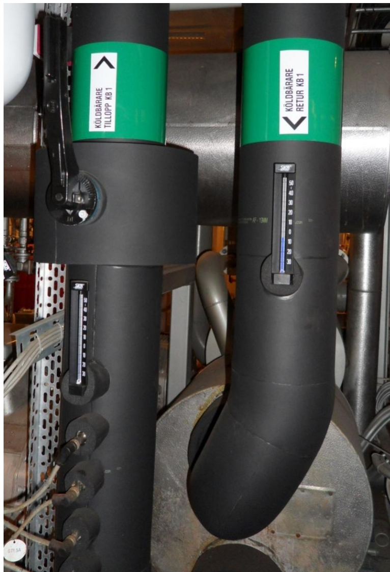
Figur 6: Termometrar på köldbärarens tillopps- och returledningar.
