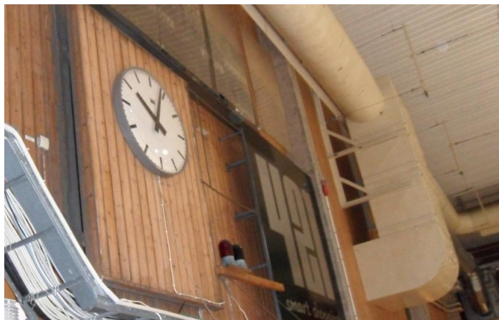
Figur 7: Återluftsintaget från hallen befinner sig bakom väggen som klockan hänger på.
