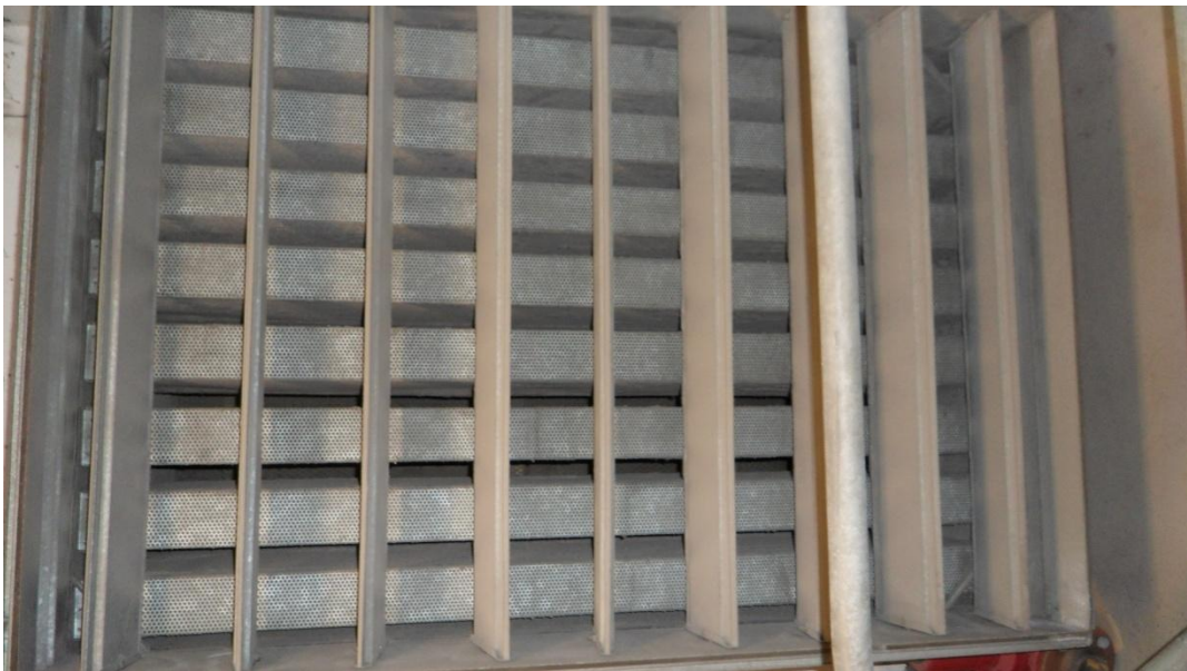
Figur 35: Återluftsintaget som vid detta tillfälle stod fullt öppet. Återluftens temperatur uppmättes till 11,4°C och den relativa fuktigheten till 52,2%.
