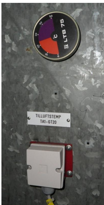
Figur 7: Termometern som visade tilluftstemperaturen till ishallen.
