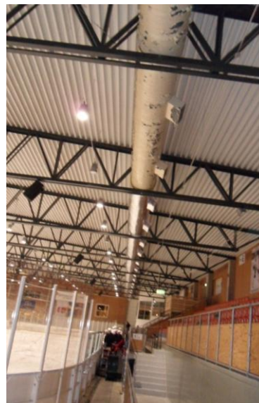
Figur 8: Tilluftskanalen över en av läktarna. Luftdonen är riktade snett ner mot läktaren. En del av tilluftskanalen är här ännu oisolerad. Se även Figur 4 och 5.
