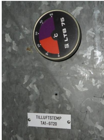
Figur 36: Termometern som visade tilluftstemperaturen till ishallen.
