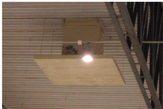
Figur 10: Ett av frånluftsdonen på nära håll.
