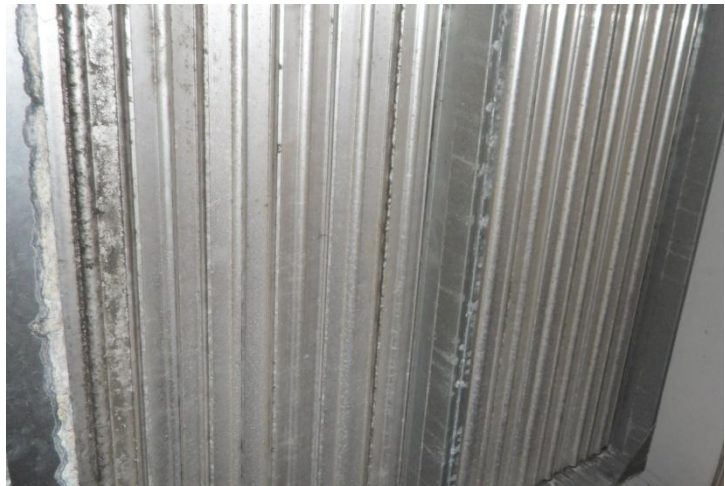
Figur 37: Spjället från uteluftsintaget var vid detta mätillfälle helt stängt, men drag pga. luftläckage kunde kännas då spjället inte var riktigt tätt.
