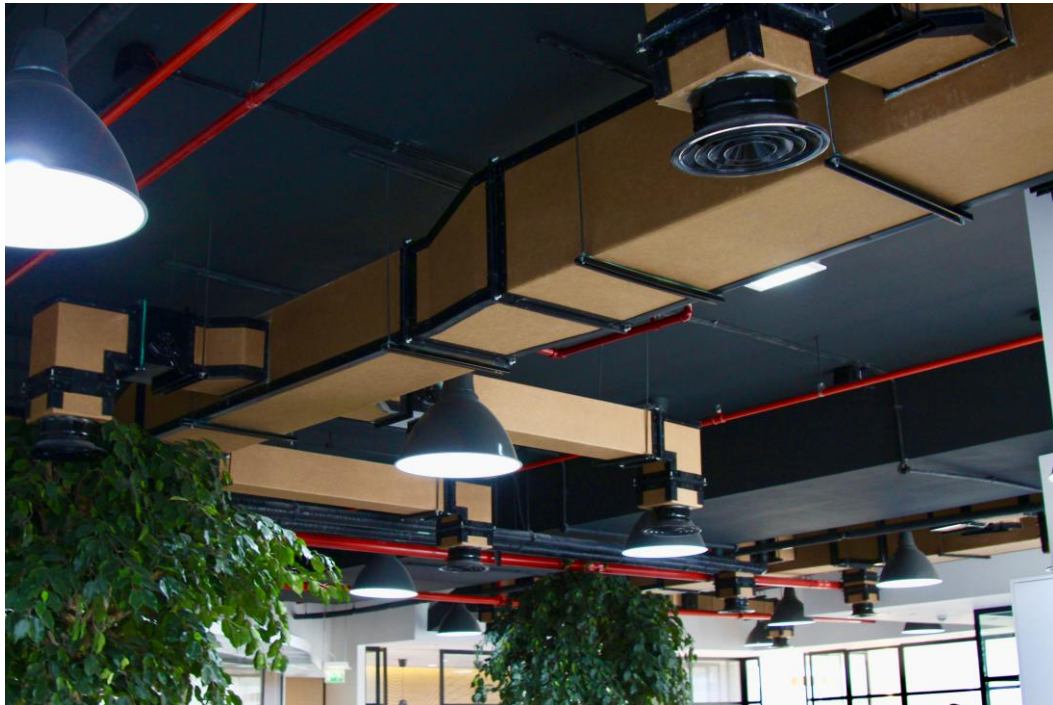
Figur 66: GatorDucts installerade kanaler av kartong.
