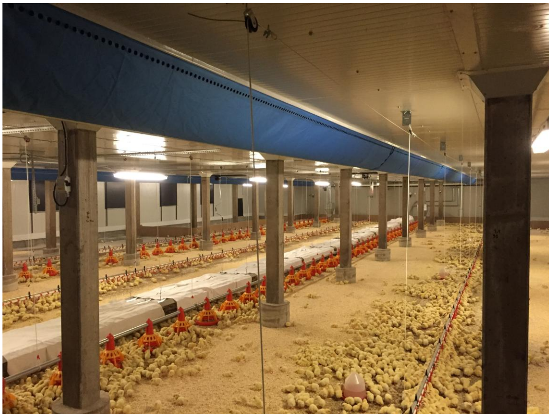
Figur 4 4: Installerade textilkanaler i en äggproduktion av REC-Indovent.
