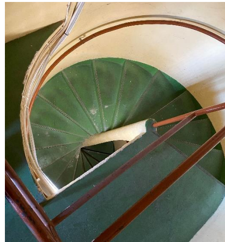
Figur 8. Trappa i västra fläktrummet (Eget foto).
