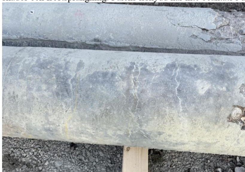
Figur 10 - Foto: Ruben Bång Brunström och Gustav Ekdahl, markering av sprickor och mätning.
