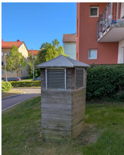
Figur 22 – ett exempel på luftintag för kulvertsystem i Göteborg.
