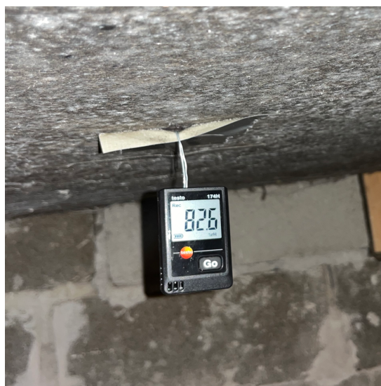
Figur 5.3.3A Placering av mätinstrumentet Testo 174H i uteluftsventilerad krypgrund för uppmätning av lufttemperatur och relativ luftfuktighet.
