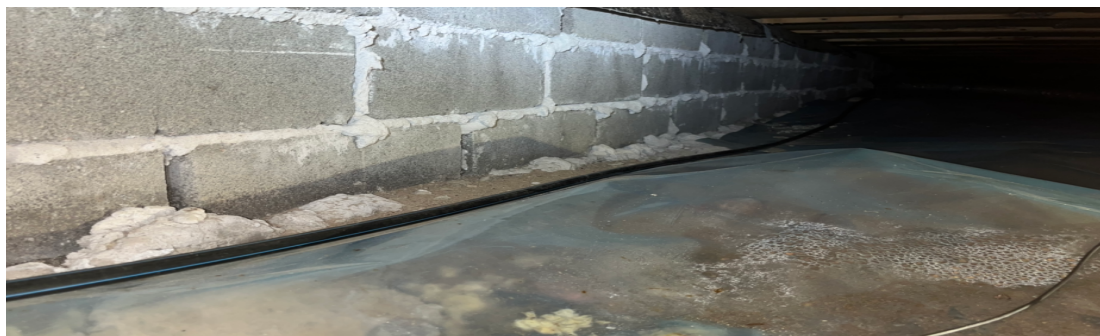
Figur 6.2.1A Kondensbildning på undersida byggplastfolie samt bristfällig överlapp av fuktdiffusionsspärr gentemot grundmur. Fotot är tagit 2023-02-28.
