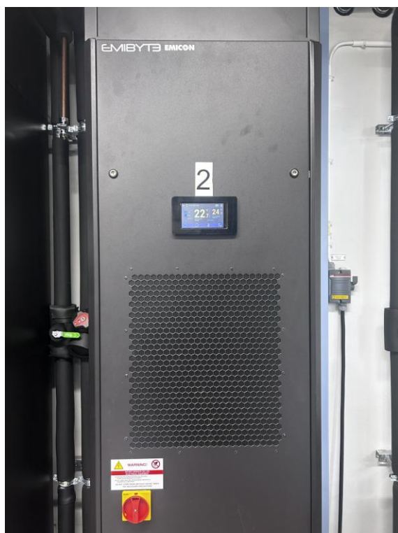
Bild 4.7: Tilluftsaggregat som användes för att uppnå önskat lufttillstånd i provrummen
