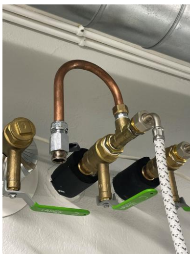
Bild 4.2: Avluftningsventil påkopplad till returvattenledning
