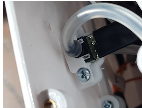
(b) Närbild på sensormontering.
