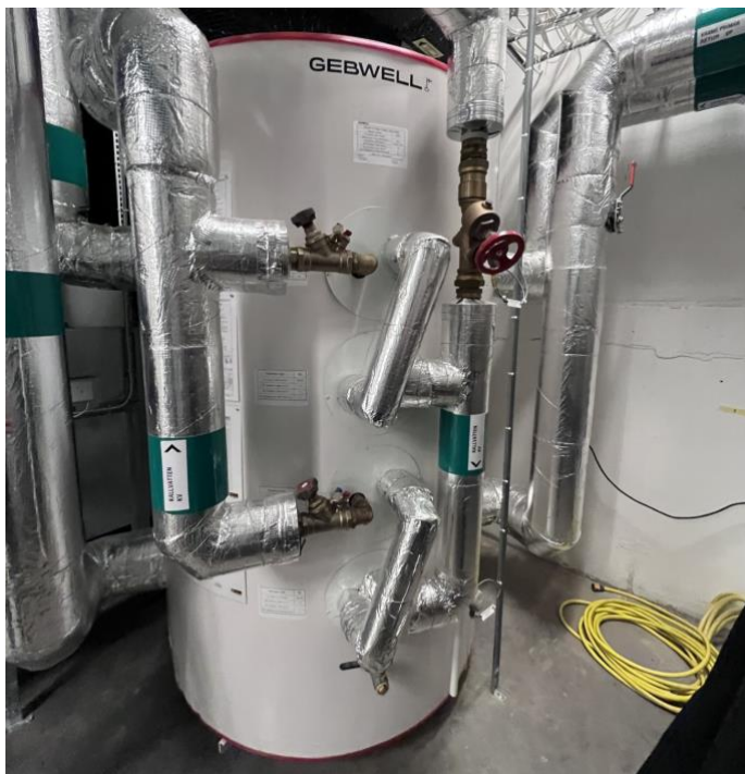
Figur 4. Ackumulatortank i Kv. Skogsvaktarens undercentral. Egen bild.
