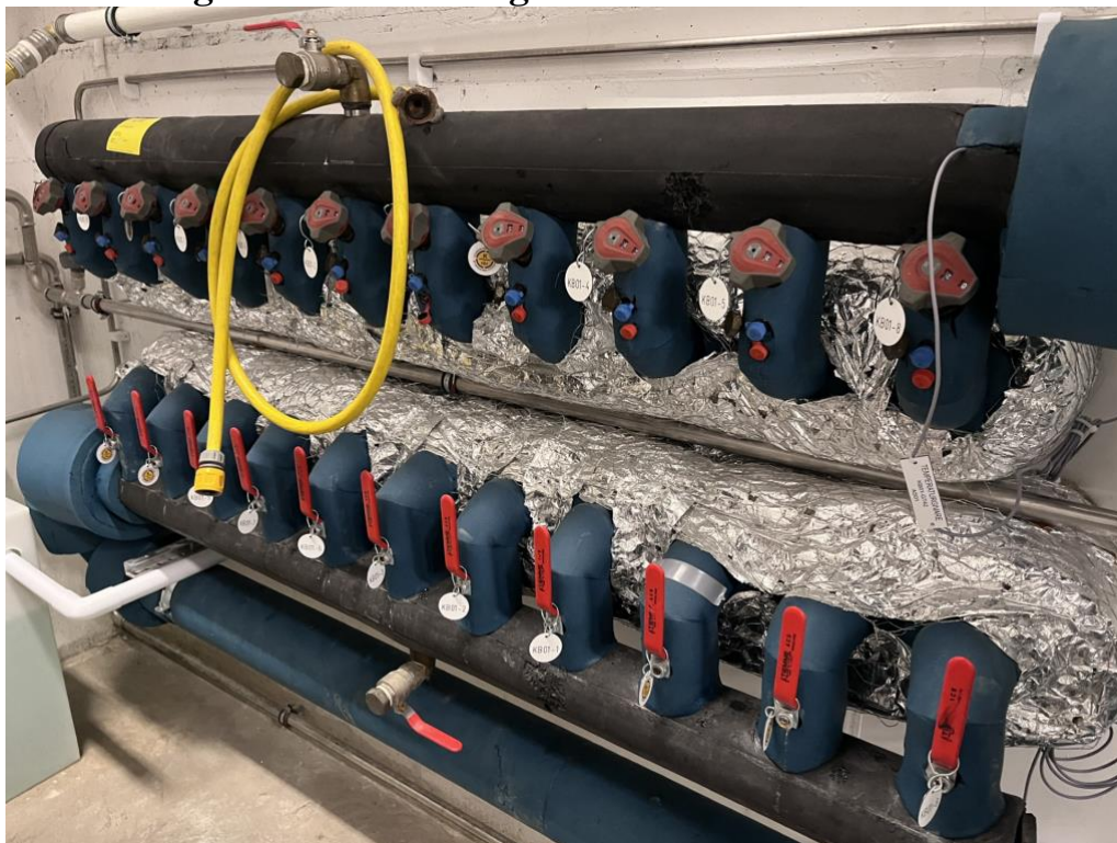
Figur 1. Inkommande borrhål till undercentralen i Kv. Skogvaktaren. Egen bild.
