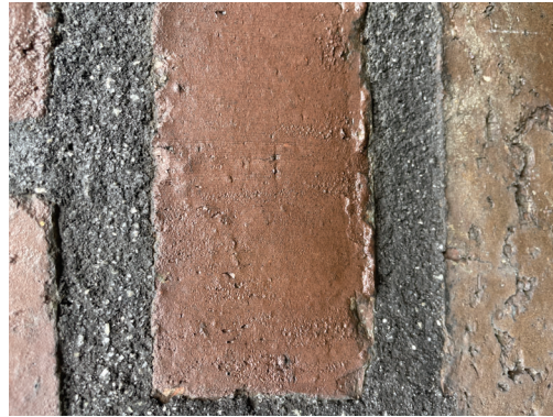
Figur 5.9: Visuellt underlag i samband med mätning av blöt tegelyta
