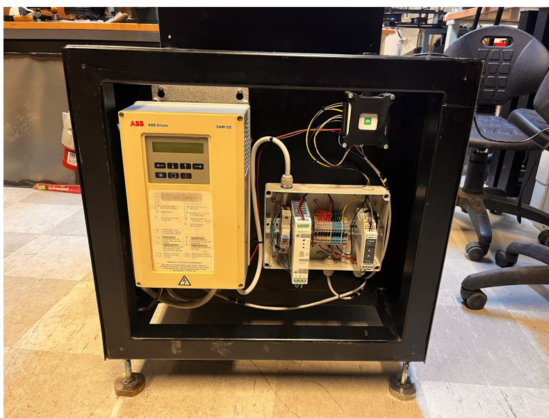
Figur 6.3: Frekvensomriktaren och lågspänningssystemet installerat i den bakre sektionen av testriggen.
