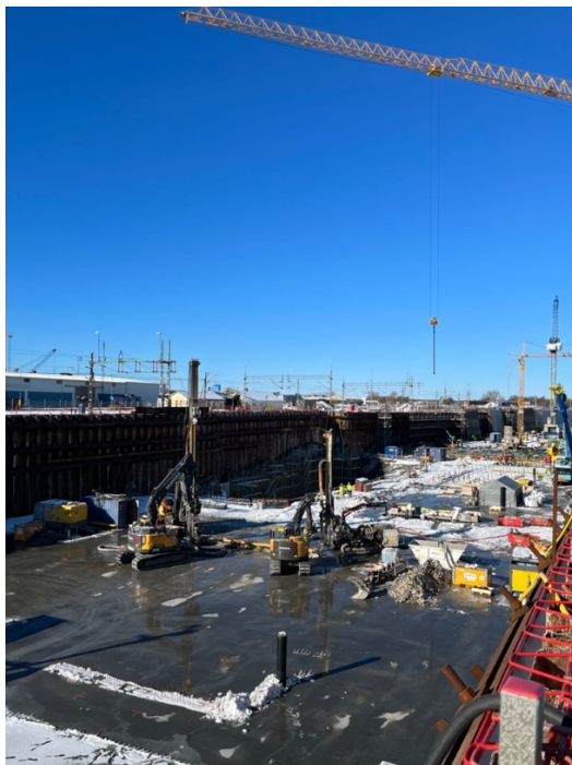
Figur 2. Bild över arbetsområdet i det norra betongtråget samt två av Skanskas borrhöggar och två av Skanskas hjälprävarer.
