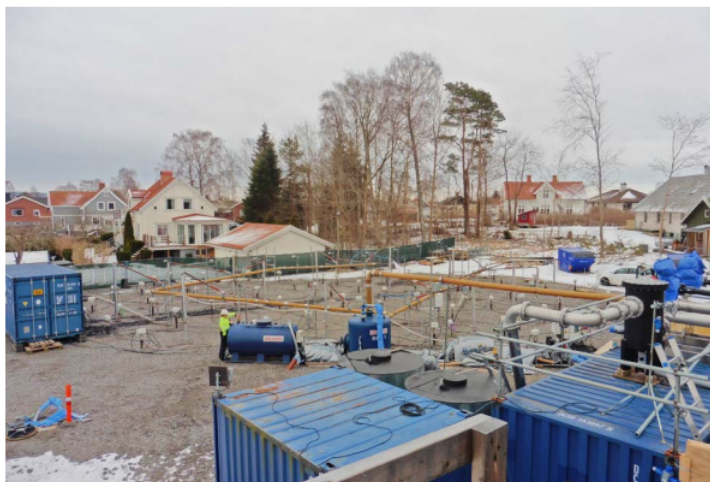
Figur 15: Fotografi från saneringen av Järnsågen 3. Fotograf: Hans Diechle, Norconsult AB. Använd med tillåtelse.
