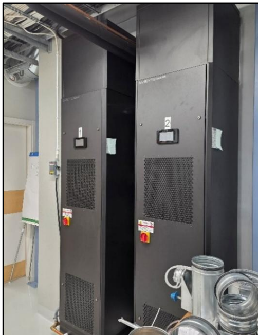
Figur 11. Luftaggregat som förser laborationsrummen med tilluft.
