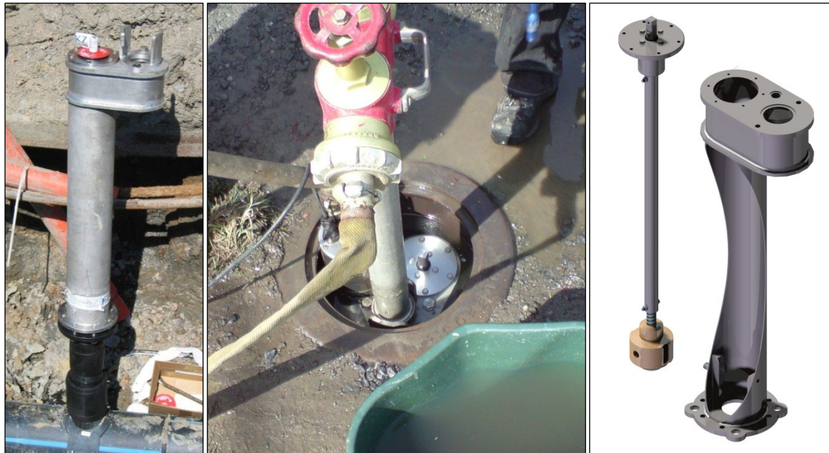
Figur 2. Brandpost ansluten till vattenledningsnätet samt cutout-view från CAD-program
