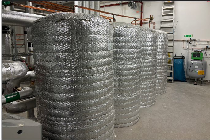
Figur 3. Ackumulatortankar i värmecentralen på Fredrika Bremergymnasiet. FOTO: Dennis Lind
