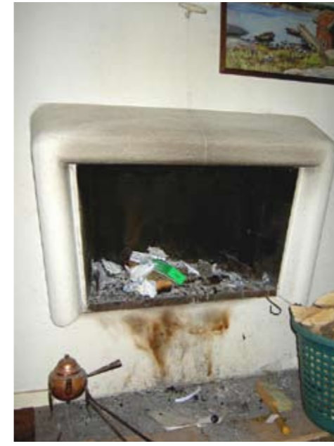
Öppen spis, olika för varje byggnadsetapp.
