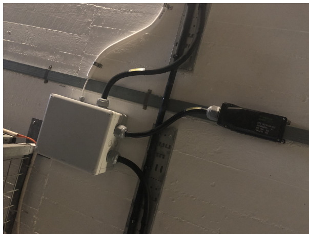
Figur 4.3: PLC i elskåp (grå) med inkommande matningskablar (svarta) från laddboxar samt nätverkskabel (vit). Kommunikation med laddboxar går genom matningskablarna.
