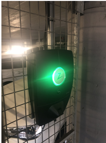
Figur 4.2: Laddbox Zaptec Pro med synlig RFID-tagga monterad på monteringsplatta på vägg intill parkeringsplatserna.
