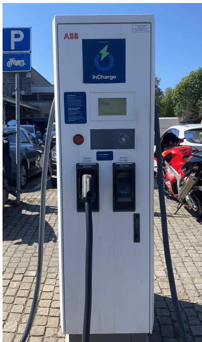
Figur 2.1: DC-laddare vid en laddstation. Bild tagen av Anton Gunnarsson.
