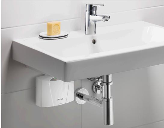
Figur 2.9.1. Genomströmningsvärmare monterad under tvättställ. Bild med tillstånd från Clage (2020).
