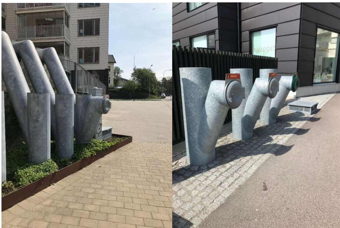
Figur 2. På bild ett och två ses installerade sopsugsinkast av Envac AB i Eriksbergs utomhusmiljö. Här slänger man sitt avfall utomhus. Foto, Joel Flakberg
