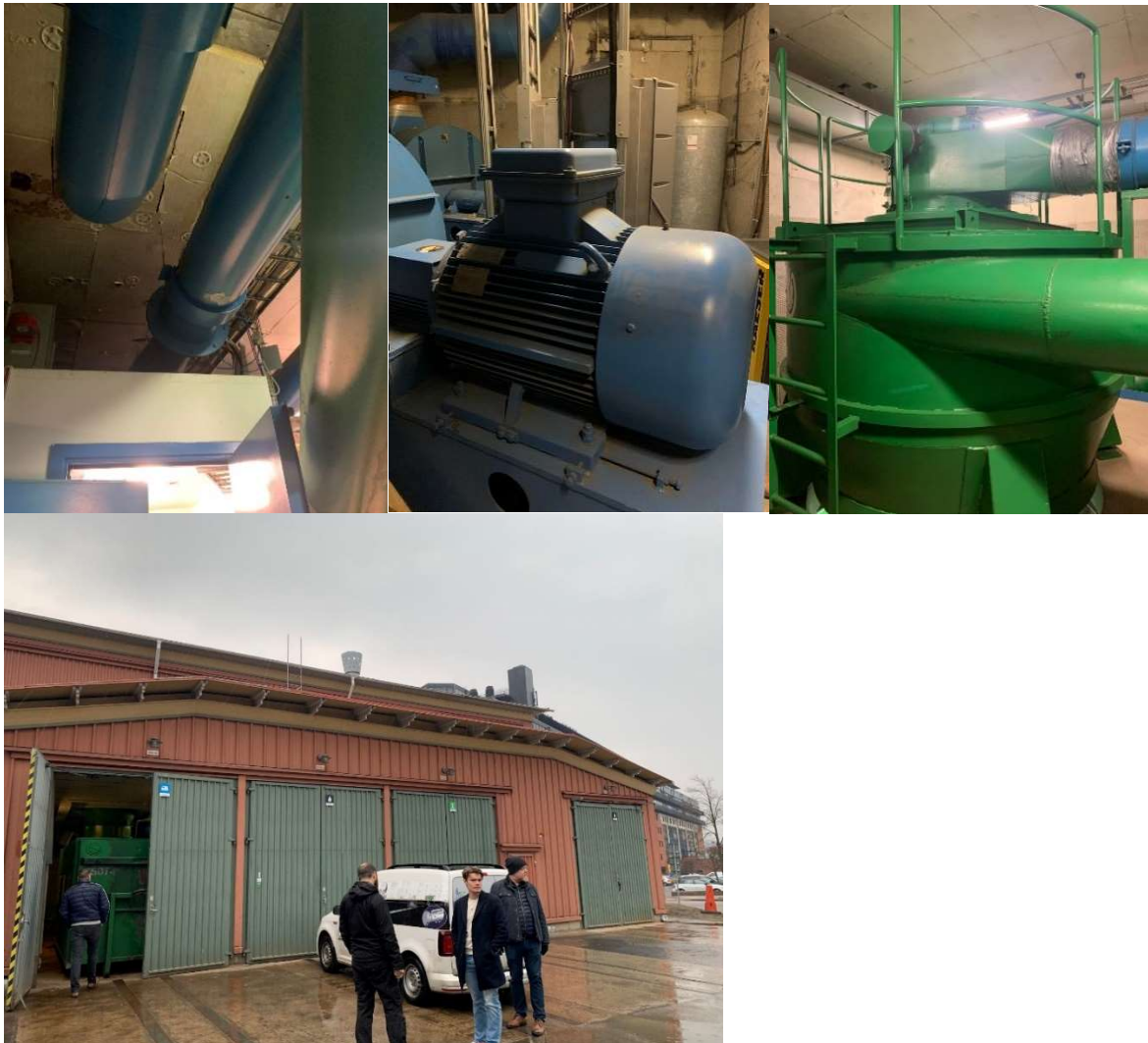
Figur 4. Inne i sopsugsterminalen i Eriksberg, Göteborg och dess komponenter. På bild ett ser vi respektive rör vilket soporna färdas i, bild två ses vi elmotorerna som driver sopsuget, bild tre är en del av containern där avfallet samlas och körs sedan iväg av sopsugar, bild fyra är terminalen. Foto, Denis Zisko
