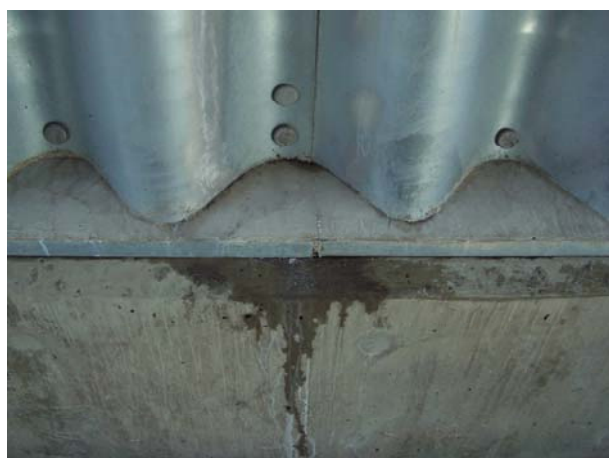
Figur 3.9 Vattenläckage mellan betongfundament och u-profil
