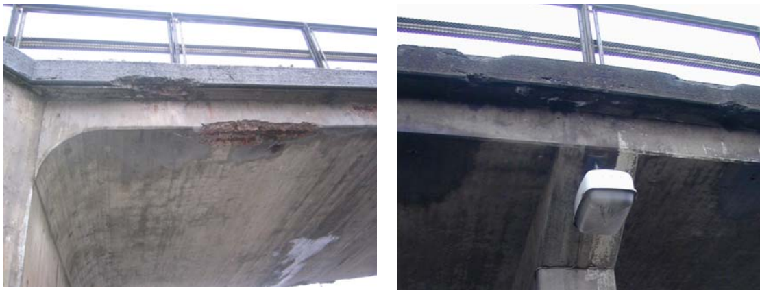
Figur 4.2 Till vänster ses skada på NO undersida platta och kantbalk. Bilden till höger visar mittstödet på norra sidan och skador på kantbalken.
