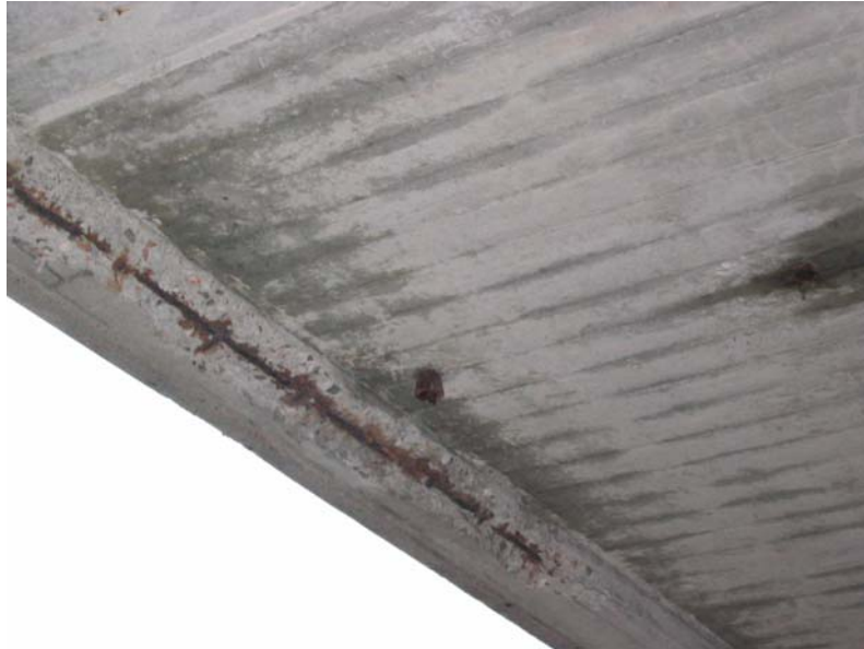
Figur 5.3 Spjälkning av den södra kantbalken.
