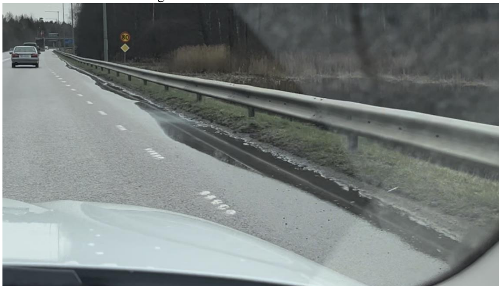
Figur 14. Vägbanan där vatten ansamlas på vägbanan som konsekvens av att avvattningsystemet inte underhållits tillräckligt.
