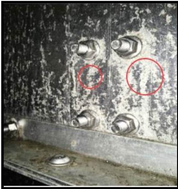
Figur 7. Aluminium utsatt för galvanisk korrosion. (Alumeco,2019)
