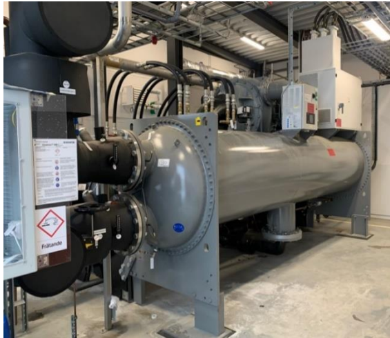
Figur 14:VKA4 komp-kylmaskin installerad vid Lindholmen.
