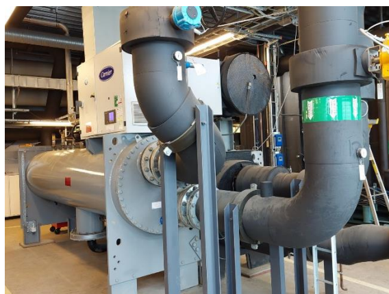
Figur 11: VKA1 komp-kylmaskin installerad vid Lindholmen.
