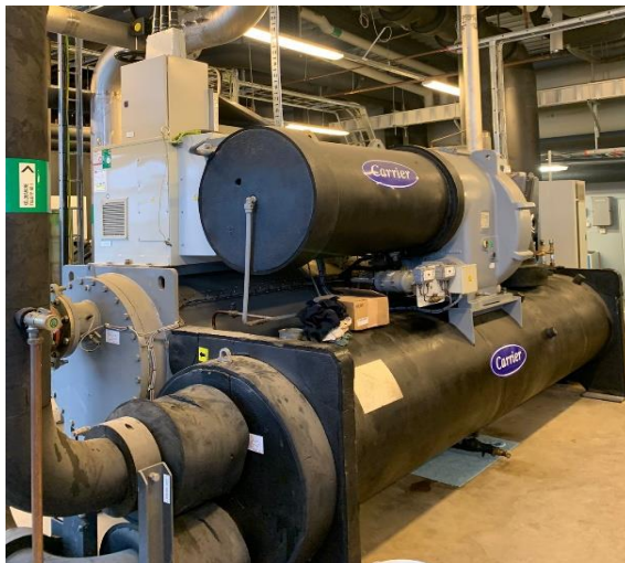
Figur 13: VKA4 komp-kylmaskin installerad vid Lindholmen.
