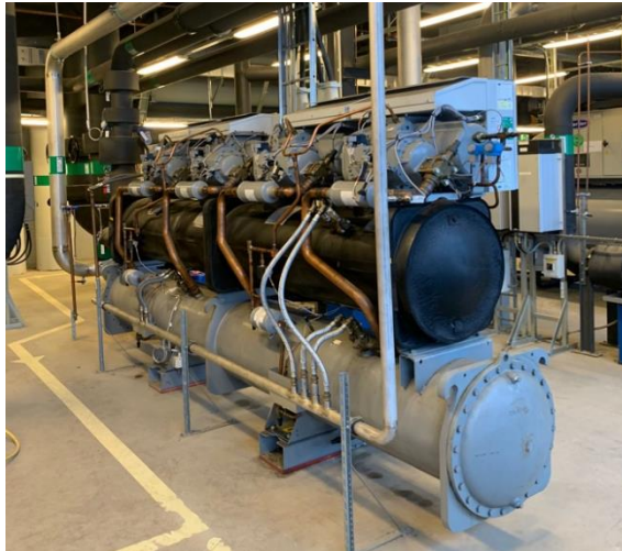
Figur 12: VKA2 komp-kylmaskin installerad vid Lindholmen.
