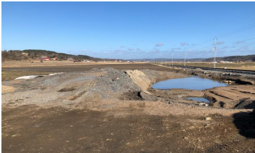
Kommentar. Överlastad omlastningsplats vid Östra Derome.
